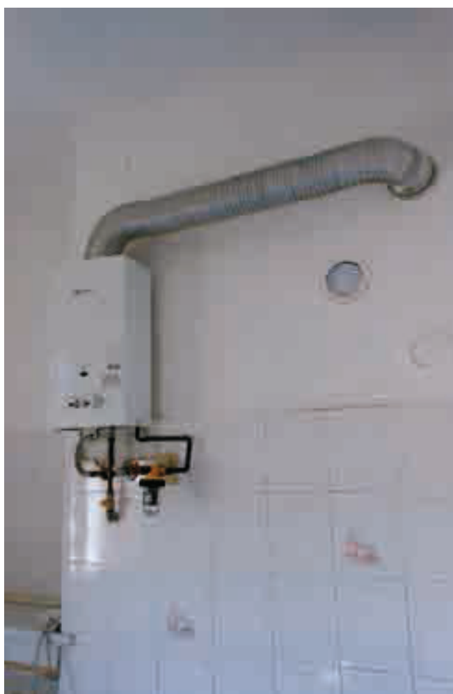
Esempio di canale da fumo non conforme e pertanto non sicuro
