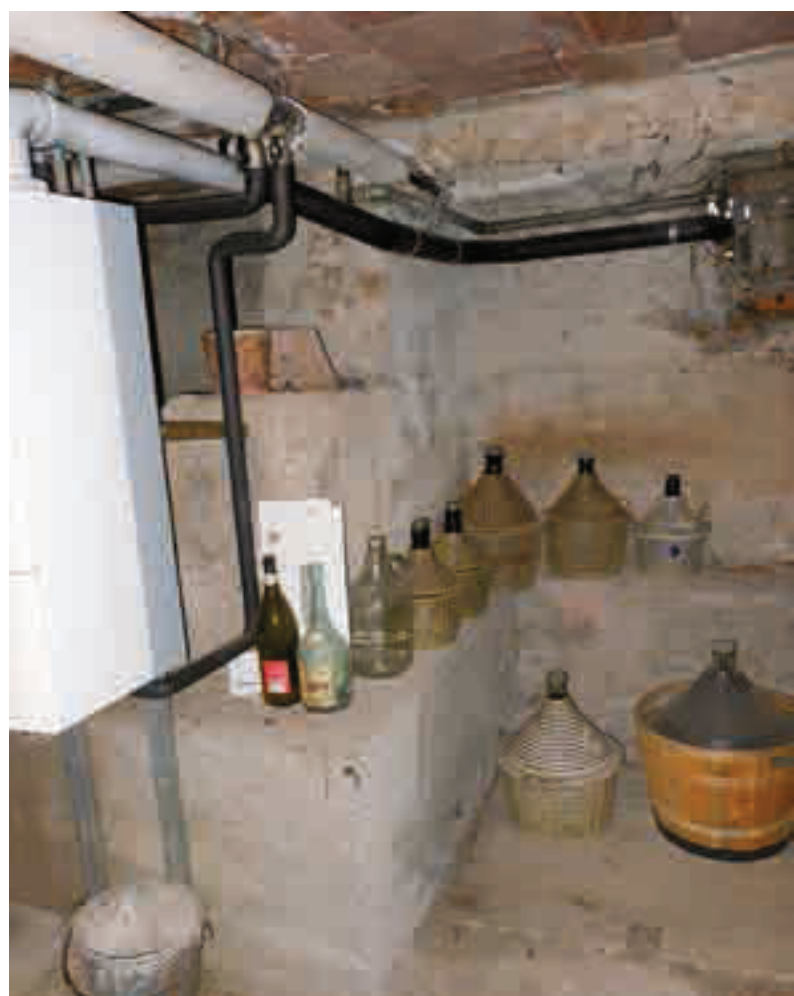
Esempio di locale non idoneo all'installazione di generatore di calore con canale da fumo non conforme
